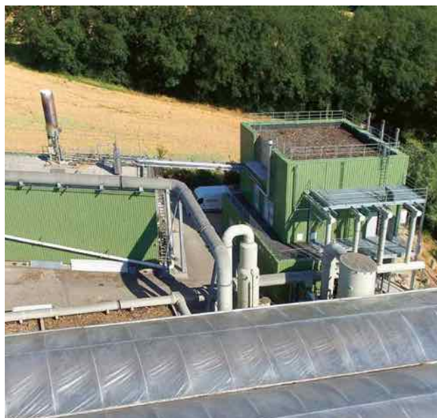
Les installations d'épuration du biogaz sur le site d'Ecorecyclage permettent d'augmenter l'injection de gaz renouvelables dans le réseau de gaz naturel et de produire de la chaleur et de l'électricité pour les besoins du site.
