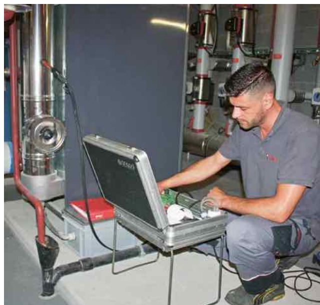
Contrôle et maintenance d'une chaudière au gaz naturel sur le site des artisans, à Forel.
