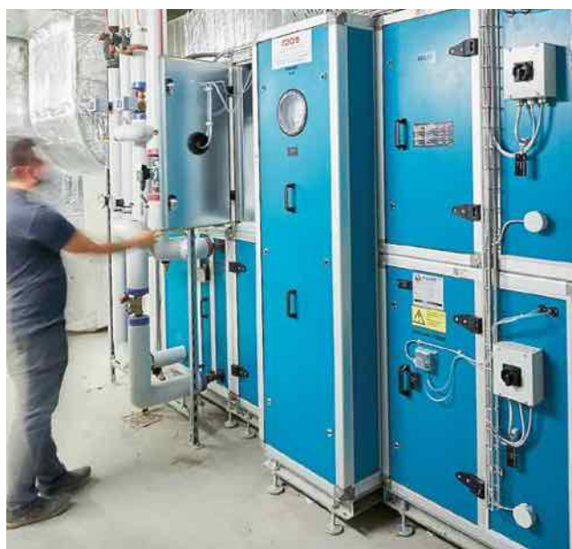
Nouvelles installations de ventilation et de rafraîchissement réalisées à la tour Bel-Air, à Lausanne.
