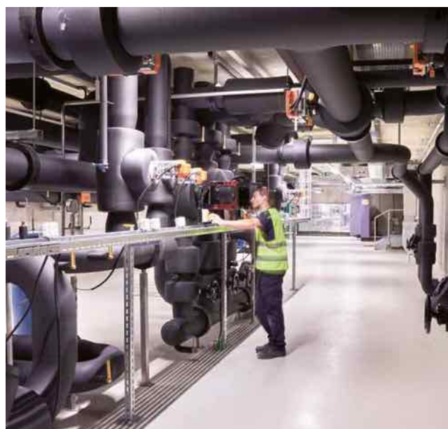
Nouvelles installations de refroidissement-chauffage au siège international de Nestlé, à Vevey.
