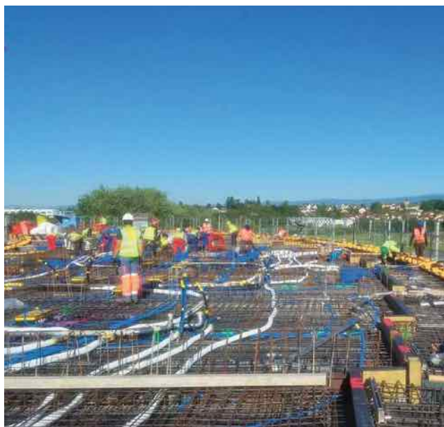
Installations sanitaires réalisées pour « Vortex », bâtiment destiné aux athlètes des JOJ 2020 et par la suite au campus de l'EPFL. Il est composé de plus de 900 logements.
