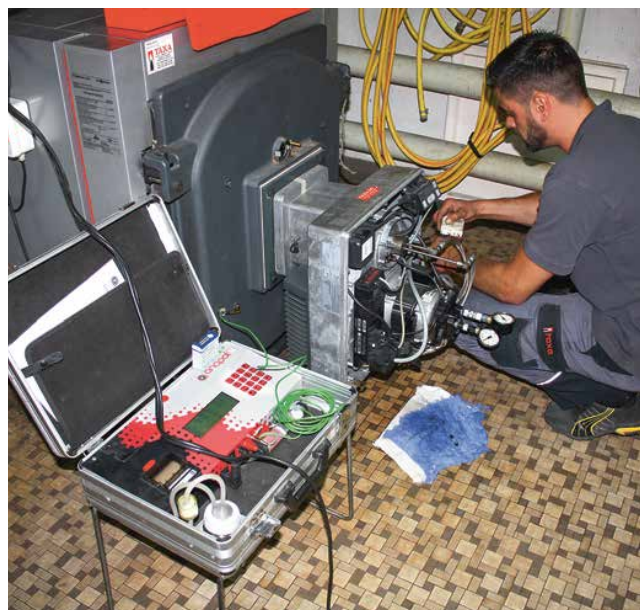
Le contrôle et la maintenance de producteurs de chaleur fait partie des activités principales de la société.
