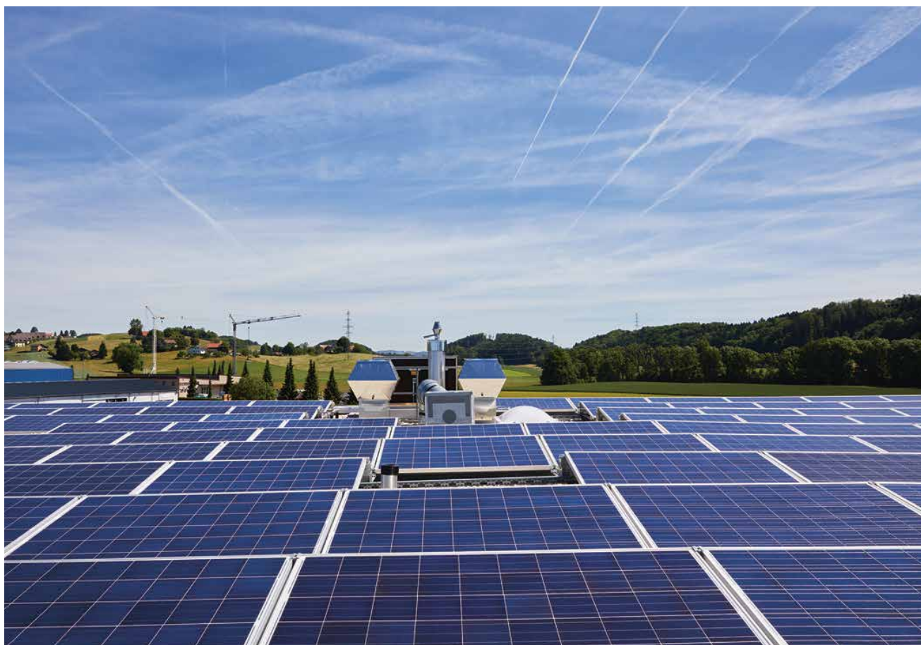
Toiture solaire photovoltaïque du bâtiment des artisans à Forel réalisée par Avena. La production électrique annuelle équivaut à la consommation moyenne de près de 25 ménages.
