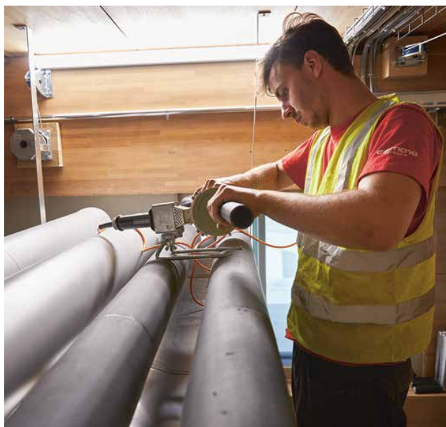
Installations sanitaires et techniques réalisées dans la Maison de l'écriture, à Montricher.
